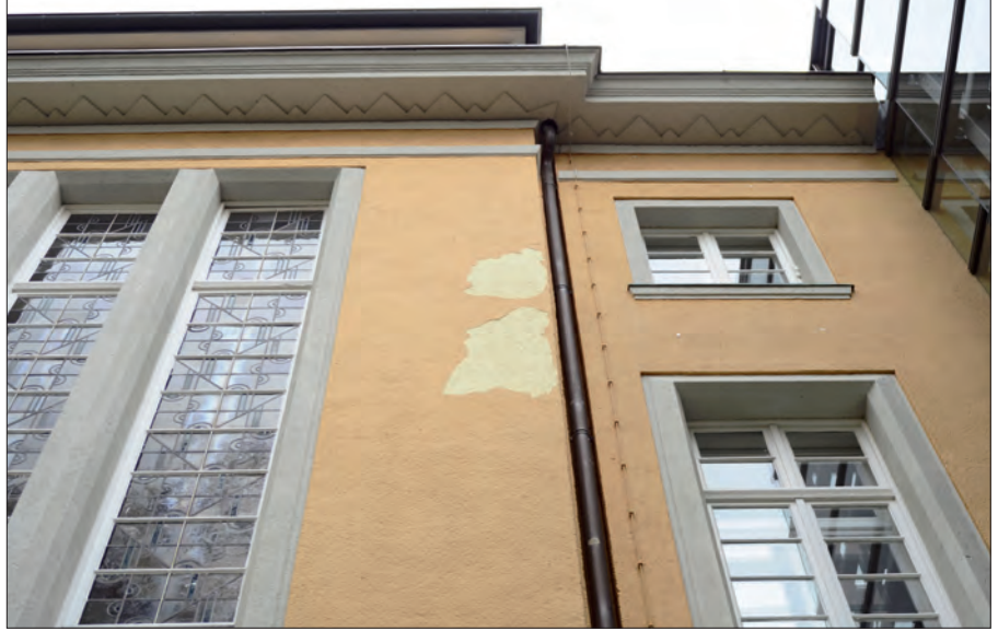
Der vorherige ockergelbe Anstrich hatte sich an mehreren Stellen der Fassade unübersehbar vom mineralischen Putz gelöst. (Foto: Achim Zielke für Alligator)
